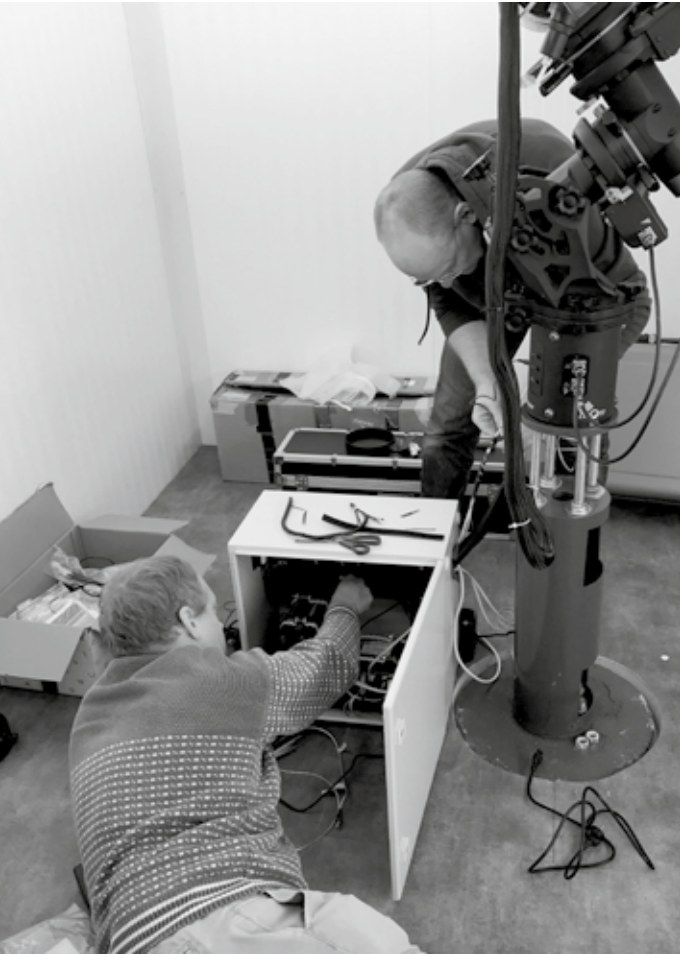
Roger och Claes jobbar med installationerna. I serverskåpet finns dubbla datorer och dubbla routere för redundans och en Raspberry Pi som möjliggör ominstallation av datorerna om båda skulle få fel. Foto: Christian Bergqvist
